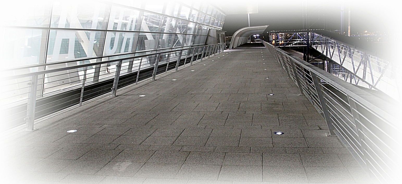
Bilbao Port - Spain - (Instalación real de balizas wireless) PASEOS MARÍTIMOS, PUERTOS DEPORTIVOS
